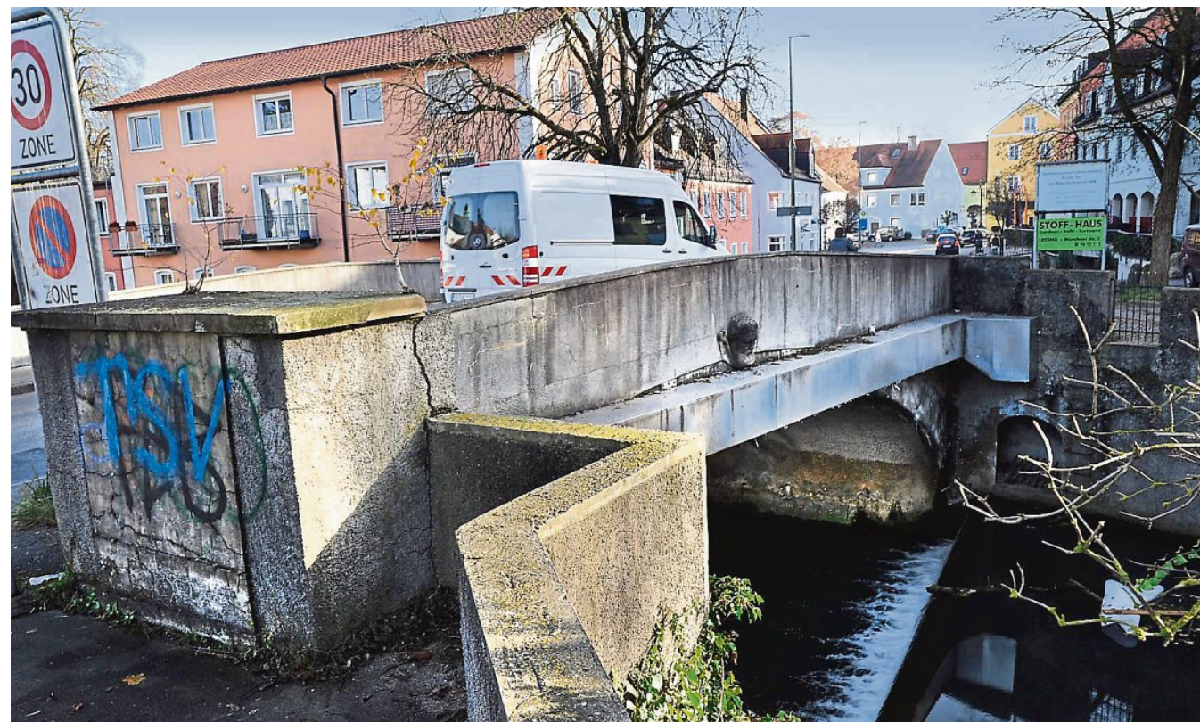
Sprinter dürfen noch drüber: Künftig ist die Freisinger Brücke über den Fehlbach für Fahrzeuge über 7,5 Tonnen gesperrt. Das marode Bauwerk kann nicht mehr Druck aushalten, haben Untersuchungen ergeben. FOTO: BAUERSACHS
